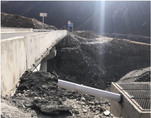
满真一号中桥 桥面径流收集系统
