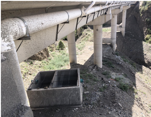
细通小桥 桥面径流收集系统
